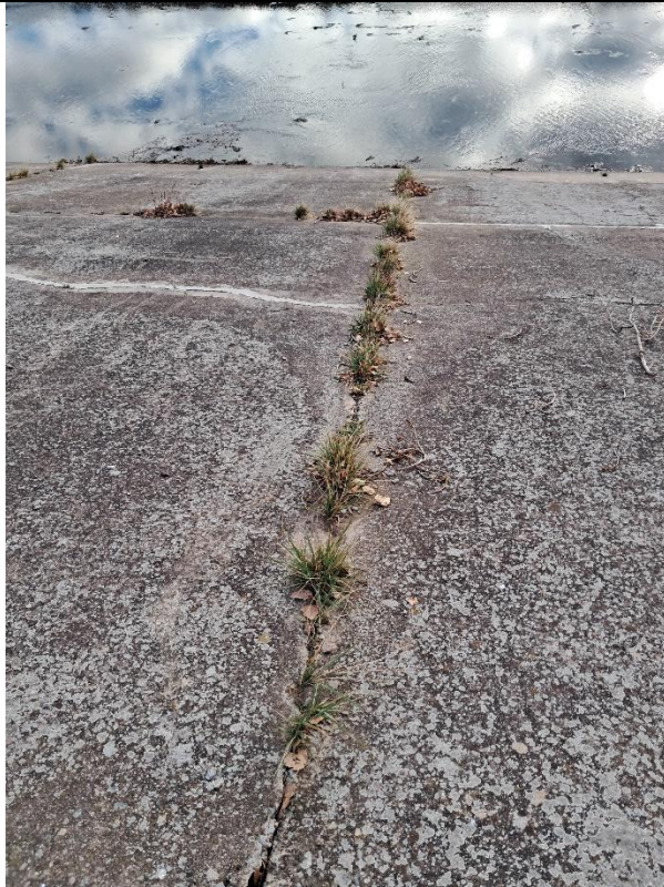
Figure 3 : Végétation présente dans un joint de fractionnement
