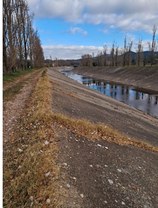
Figure 7 : Présence d'arbres (vieillissants ou morts) tout au long des digues
