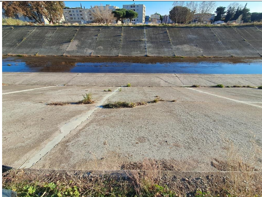
Figure 5 : Dalle fissurée et végétation présente, reprise des joints de fractionnement sur la dalle observée
