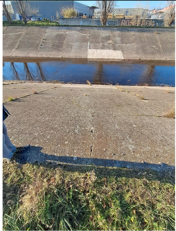
Figure 4 : Fissure sur une dalle du parement
